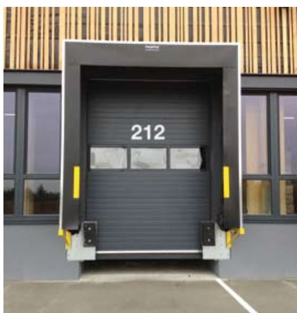
← Gut gedämmte Laderampen sorgen im Gebäudeinneren für minimale Temperaturschwankungen.
